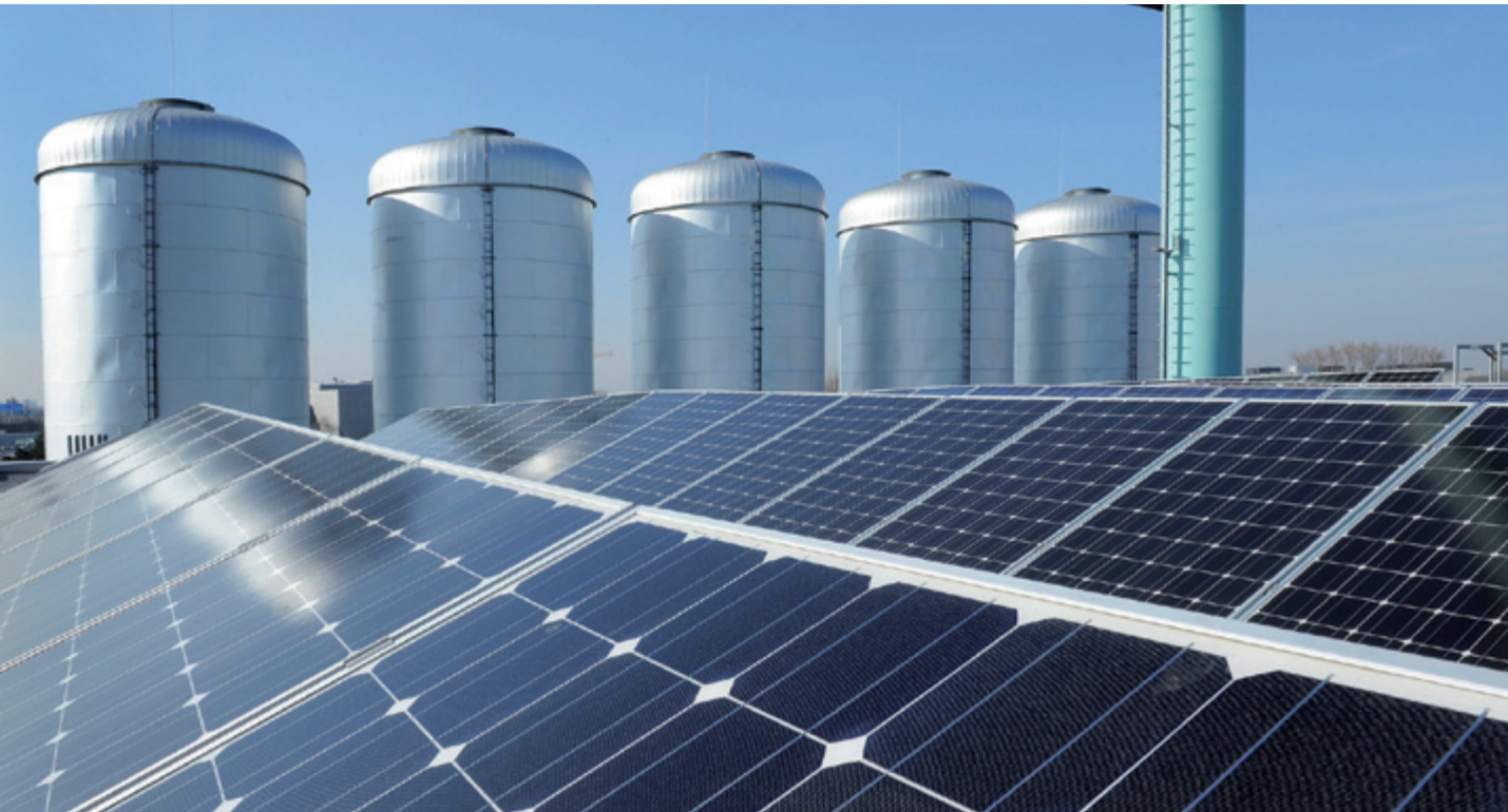
Neue Warmwasserspeicher und Solarpaneele der BTB
