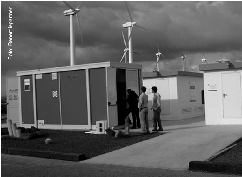
Die Technik steckt im Container: Wind-Wasserstoff-Kraftwerk mit Meerwasseraufbereitungsanlage auf Gran Canaria
